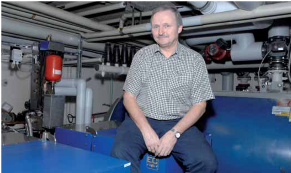
Med de nye units skal Poul Søndberg ikke mere bruge tid på dagligt at tjekke olie og vand på gasmotoren. Det er han glad for.
